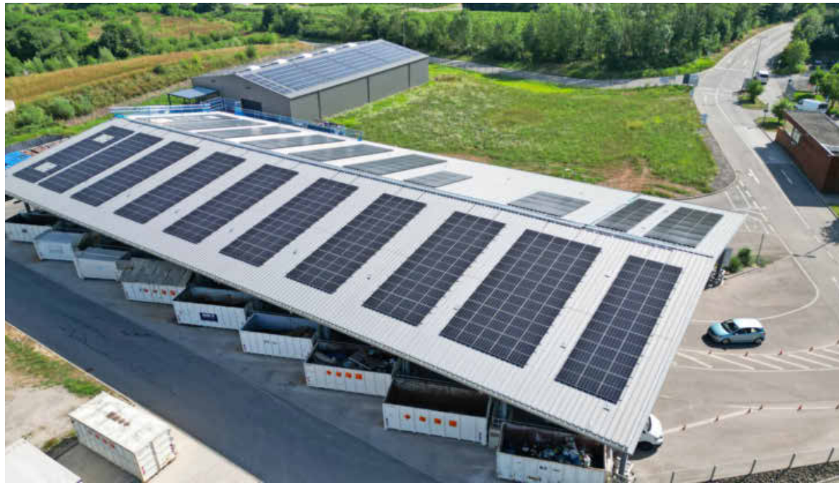
Auf der Dachfläche des Recyclinghof Plus befindet sich jetzt eine Photovoltaikanlage. Foto: Entsorgungsbetriebe
